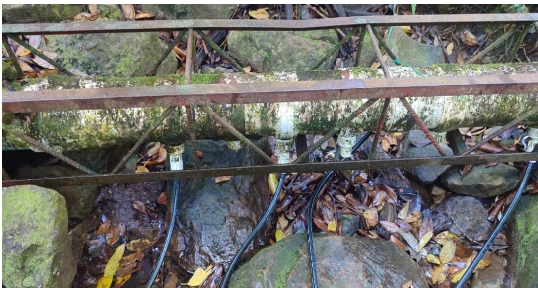
Figura 14 tubo matriz distribución de agua en Viotá.
