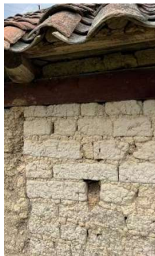
Ilustración 44. Patologías del adobe
