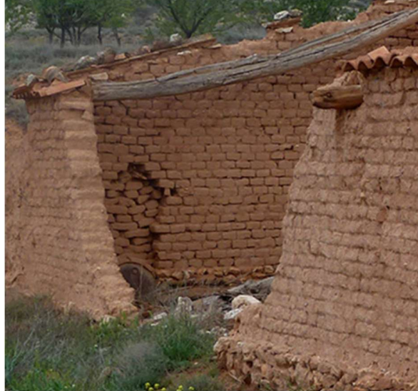
Ilustración 49. Patologías del adobe
