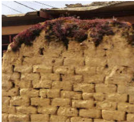
Ilustración 48. Patologías del adobe
