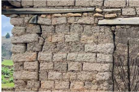
Ilustración 47. Patologías del adobe
