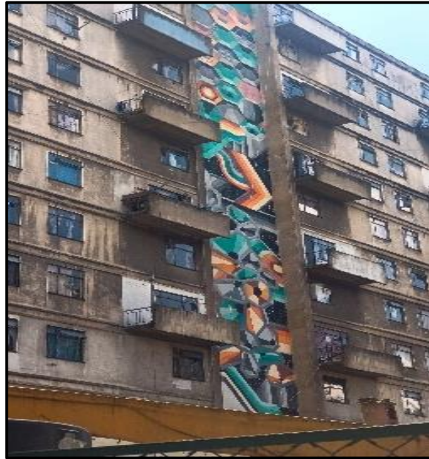
Figura 74 Muestra de fachadas, donde se observa los materiales y pinturas dañadas. Ramírez 2024.
