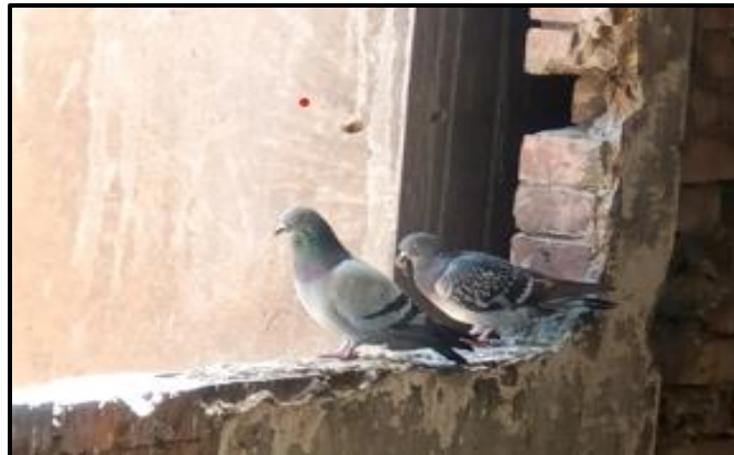
Figura 38 Presencia de aves que deterioran las fachadas y estructuras. Ramirez 2024.
