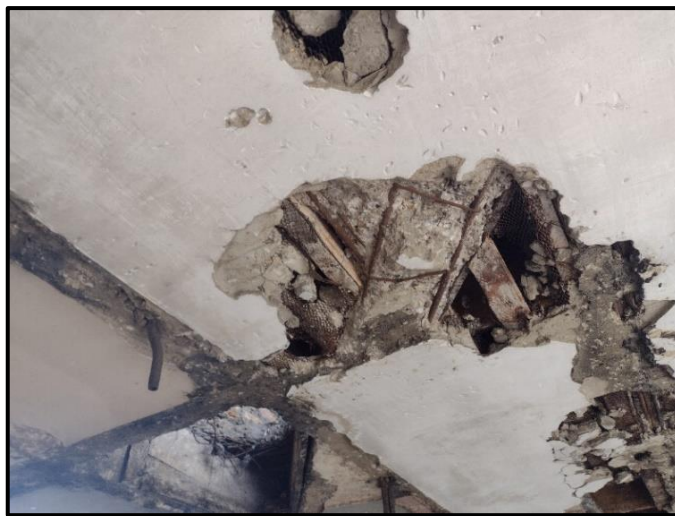
Figura 39 Presencia de carbonatación en estructura de aceros, en placa y vigas de cimentación. Ramírez 2024.
