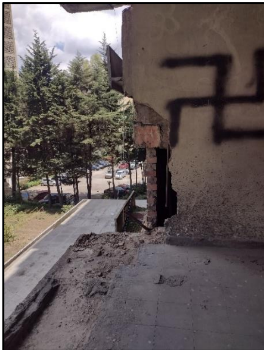
Figura 60 Se hace necesaria la Adecuación de las Instalaciones. Ramírez 2024.
