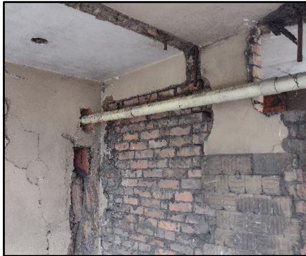
Figura 73 Muestra de la humedad, moho, daño en las estructuras y muros. Ramírez 2024.
