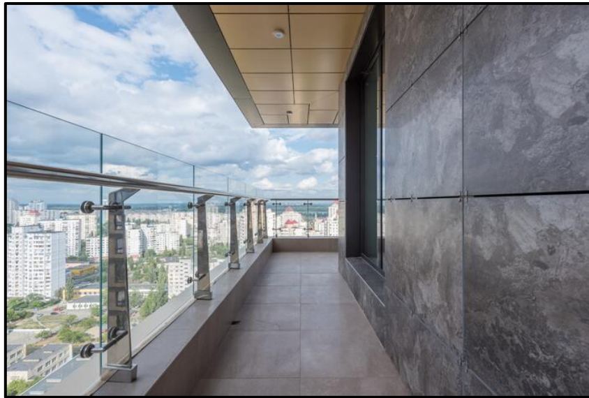
Figura 84 Configuración Mediante Barandas Acero inox y Vidrio de Seguridad en Terraza Transitable.
