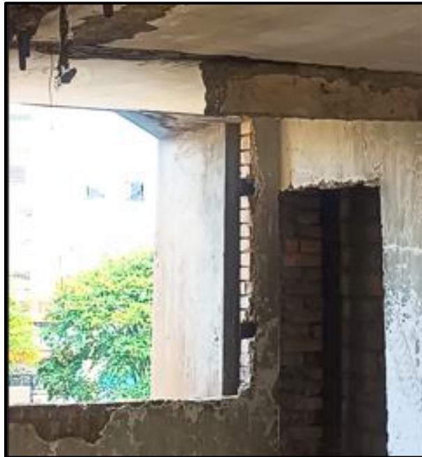
Figura 93 Presencia de revoques por humedad, cambios de temperatura, mala calidad de materiales o por efectos del tiempo. Ramírez 2024.
