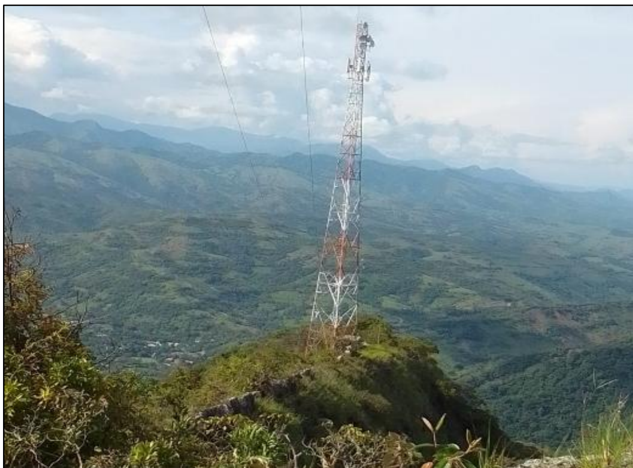
Figura 19 torre de telecomunicaciones cerro venado. Autor.ingytelcom. s.f.
