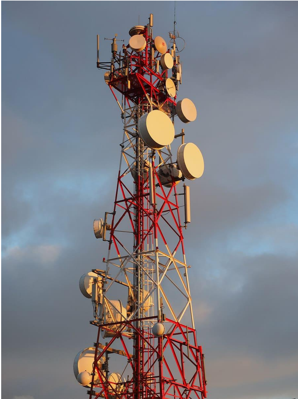
Figura 27 torre de telecomunicaciones con antenas. Autor. Adaptado de pixabay. S.f.
