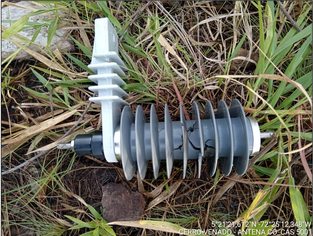
Figura 20 Daño en DPS Dispositivo de protección contra sobretensiones y transformador. Autor. ingytelcom. s.f.
