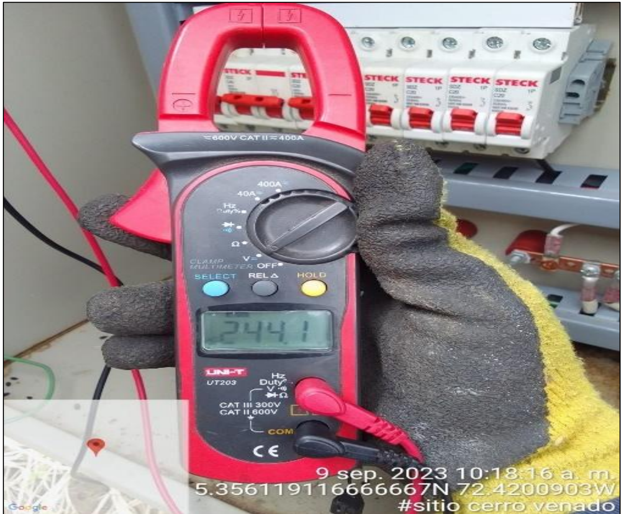
Figura 21 Medición eléctrica sobre equipos de telecomunicaciones. Autor.ingytelcom. 2023.
