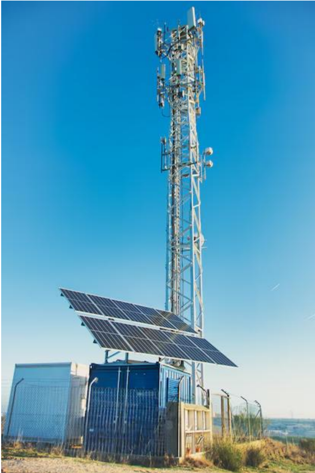
Figura 28 torre de telecomunicación con energía solar. Autor. Adaptado de freepik. S.f.
