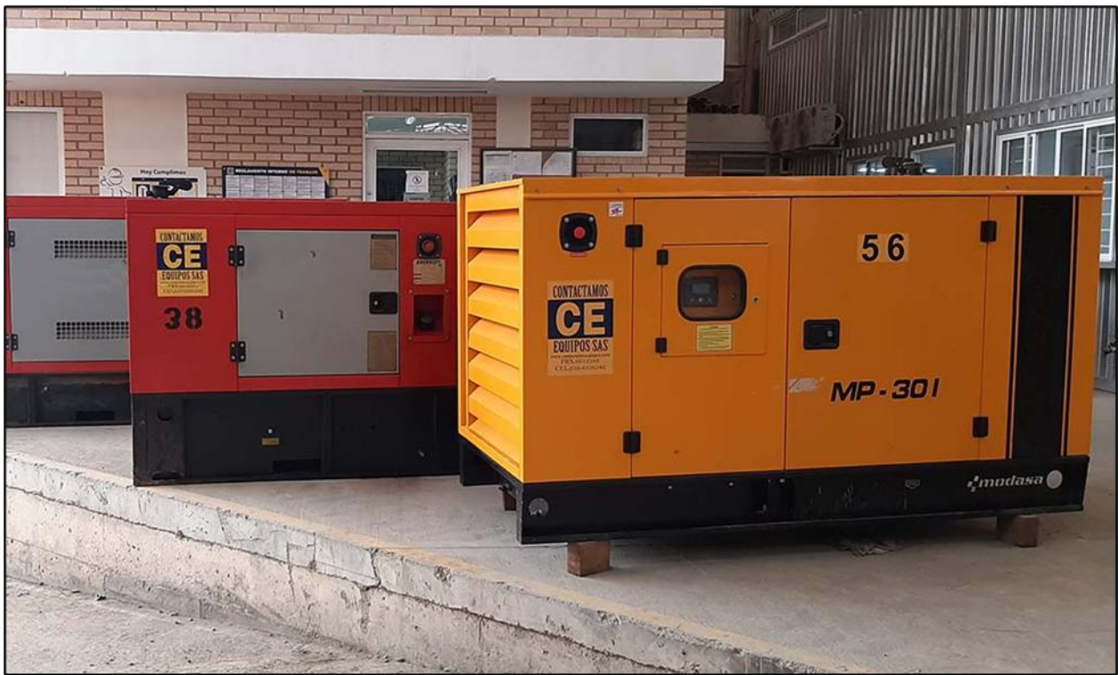
Figura 25 plantas eléctricas diésel. Autor. Adaptado de Contactamos Equipos SAS. S.f.
