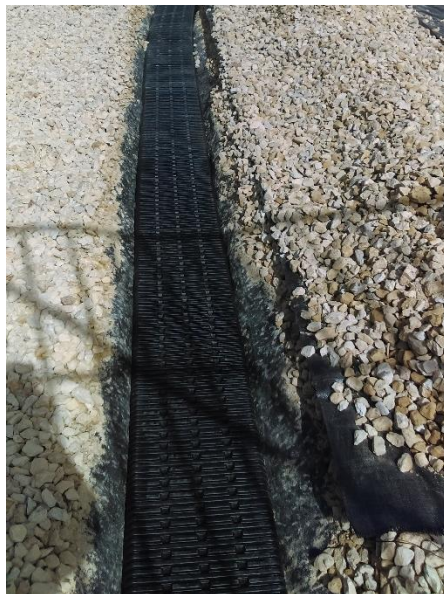
Ilustración 35 Lecho filtrante en grava (2019). Fuente: Propia
