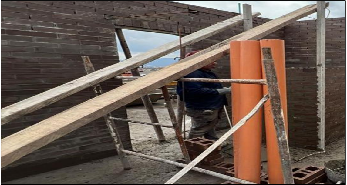
figura 22;Mal uso de sección de andamio tubular
